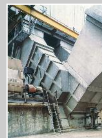
FINAL ID FAN
