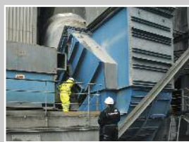
CEMENT MILL ID FAN
