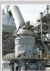
RAW MILL ID FAN
